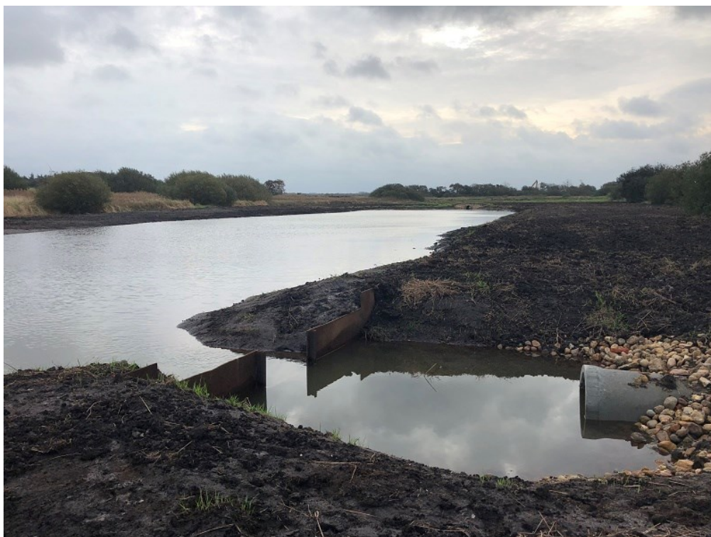
Nyetableret okkerrensingsanlæg ved Lykkegrøften, der er et okkerbelastet tilløb til kommunevandløbet Hemmet Bæk, i Ringkøbing-Skjern Kommune. Det nye okker-rensingsanlæg er gennemført i efteråret 2018 og fotoet viser det nye afløb fra anlægget. Foto: Per Søby Jensen.
