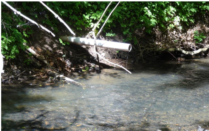
Figur 14: Eksempel på rørtilløb på projektstrækningen, hvor der skal etableres stenstryg.
