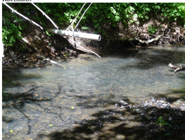
Figur 6: På vandløbsstrækningen nedstrøms fisketrappen til sammenløbet med bagkanalen, er registreret 4 rørtilløb fra venstre. Tilløbene vurderes at være afvanding fra Solevadvej nr. 42, Enggård.
